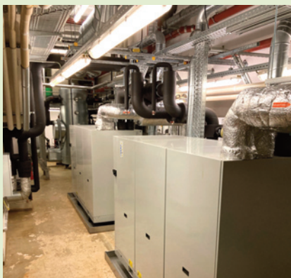
Zwei neue hocheffiziente elektrische Kältemaschinen sorgen für eine verbrauchsarme Kaltwasserproduktion für die Gebäudekühlung.
